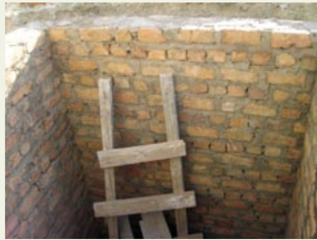
Put van het toekomstige station in Lubumbashi aan de UNILU. Puits de la future station de Lubumbashi à l'UNILU. Shaft at the future Lubumbashi station at UNILU.
